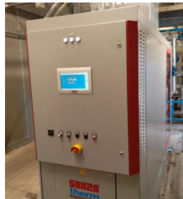
COGENERATORE "piccolo" matricola 3176860
