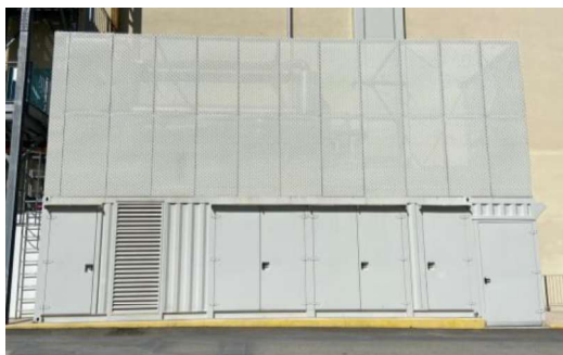
COGENERATORE "grande" matricola 35806577
